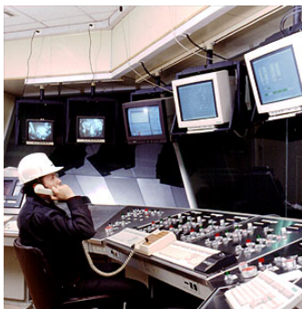
Sala de Control
